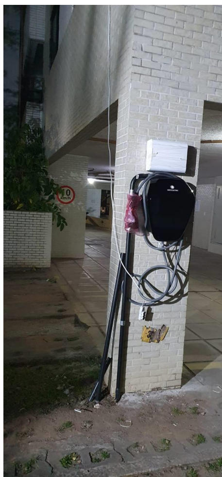
Figura 38 - Carregador veicular inserido após edificação construída
