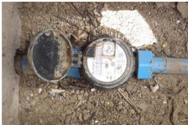
Figura 6 – Hidrômetro cujo mostrador encontra-se ilegível
