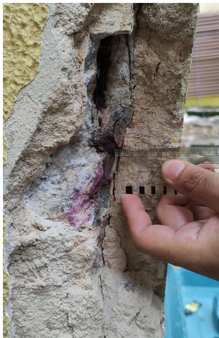
FIGURA 9 - Alteração de coloração de parte da armadura exposta
