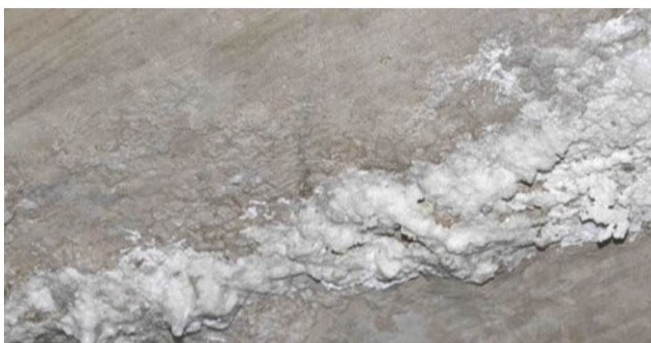
FIGURA 2 - Processo de lixiviação do concreto
