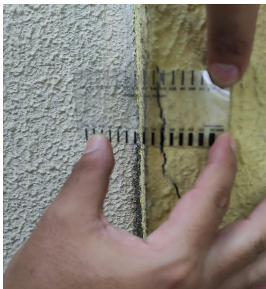
FIGURA 6 - Medição da espessura da fissura no pilar
