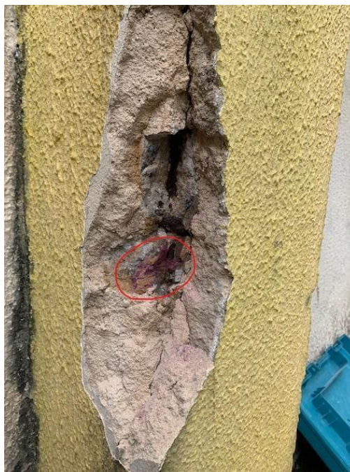
FIGURA 11 - Alteração de coloração de parte da armadura exposta
