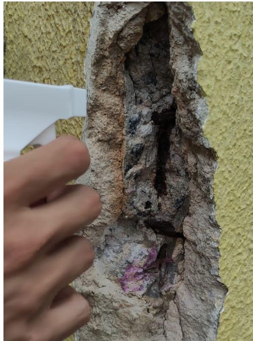
FIGURA 10 - Aspersão de solução de fenolftaleína na armadura exposta
