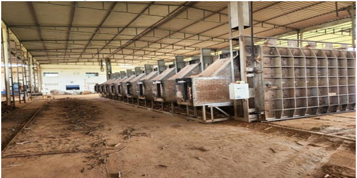
Figura 5 - Fornos Móveis Metálicos da Cerâmica Alagoas.
