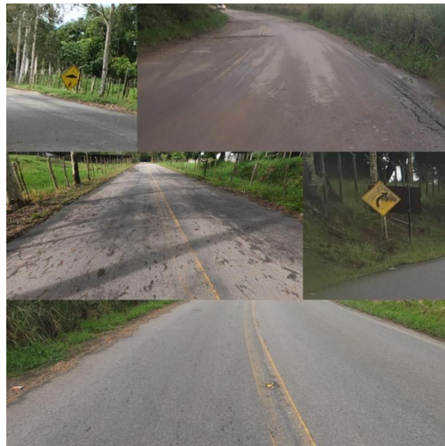
Figura 10 – Defeitos de sinalização
