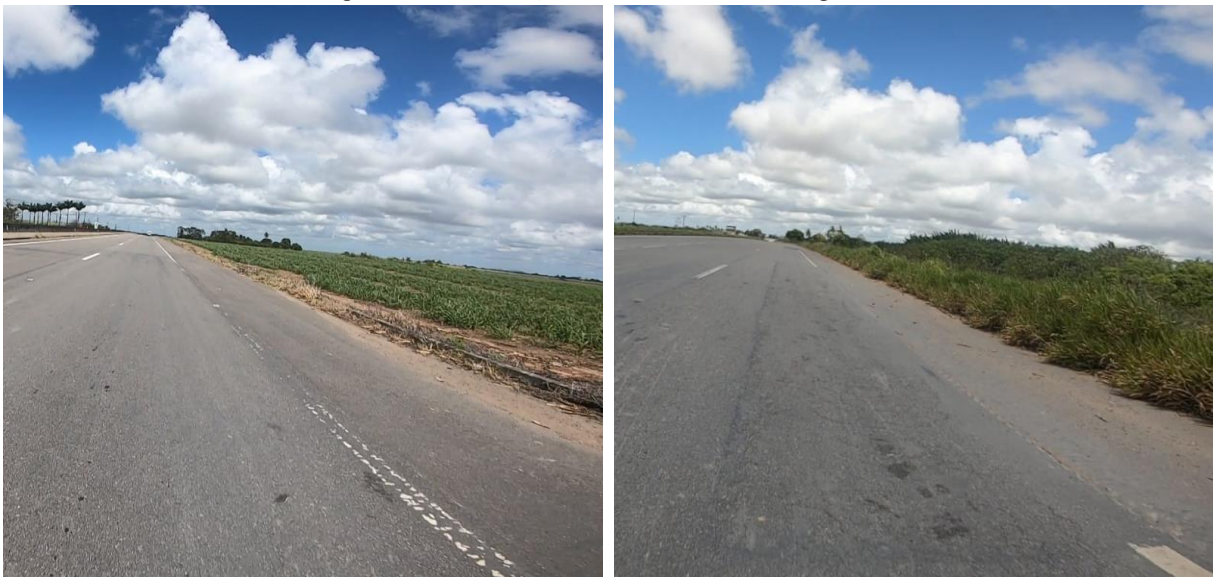
Figura 21 – Sinalização horizontal oculta e desgastada
