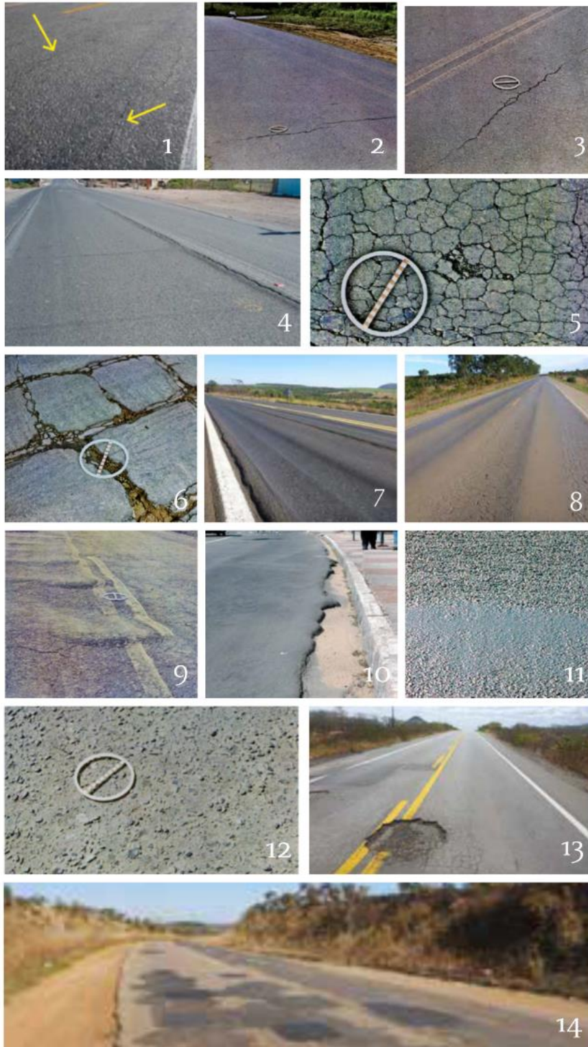
Figura 3 – Defeitos dos pavimentos flexíveis
