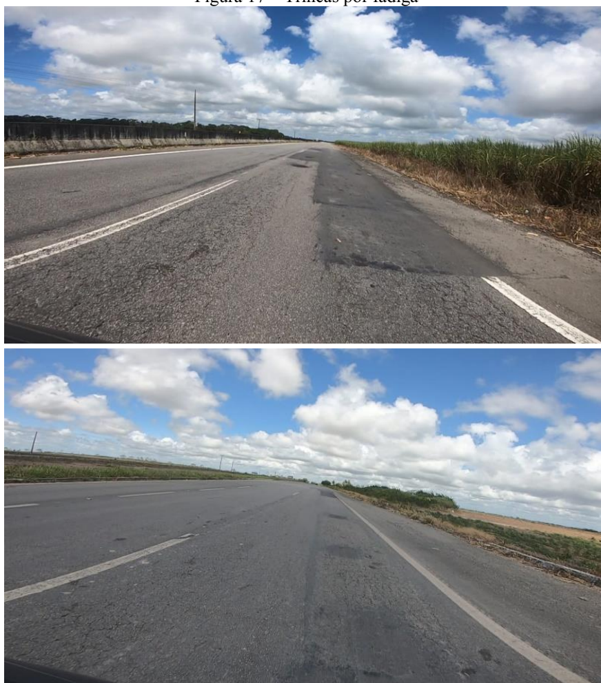
Figura 17 – Trincas por fadiga
