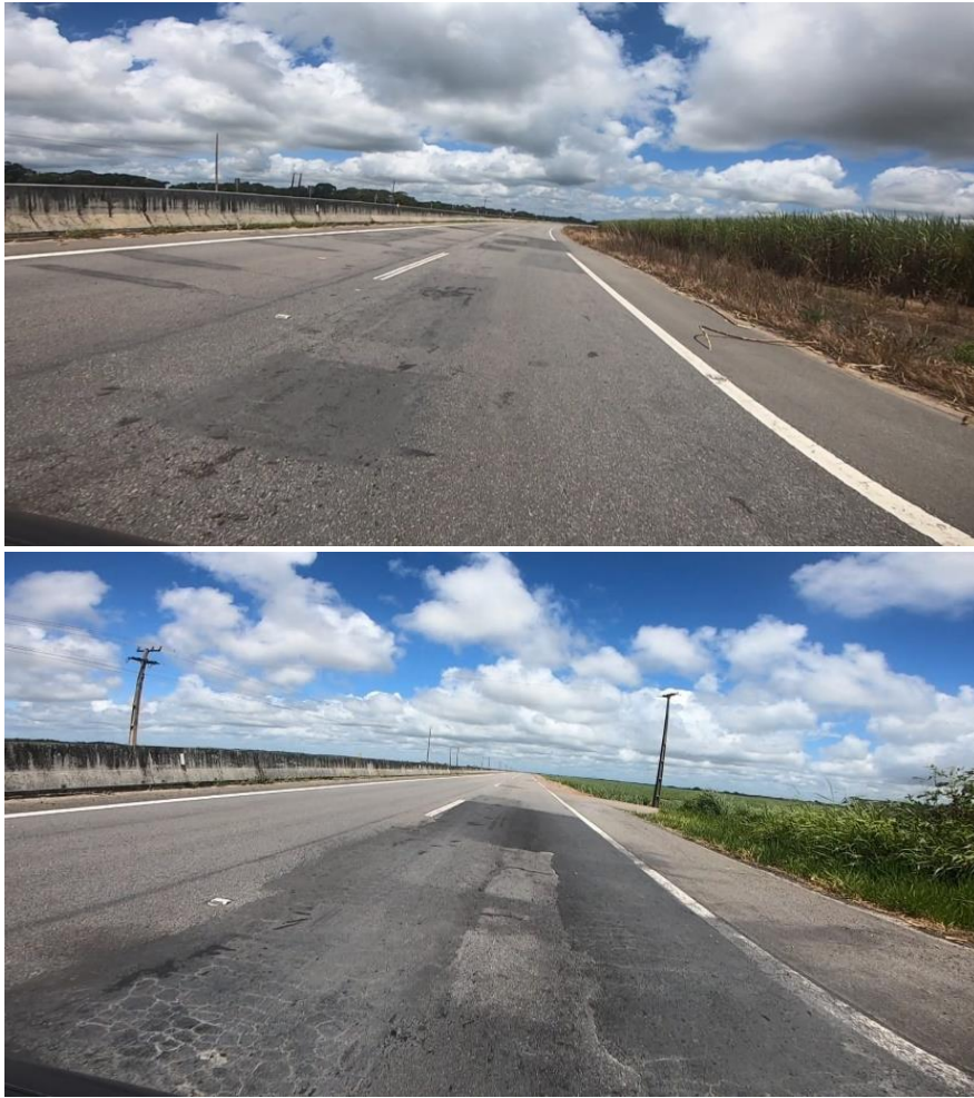
Figura 16 – Remendos no sentido crescente da AL-220
