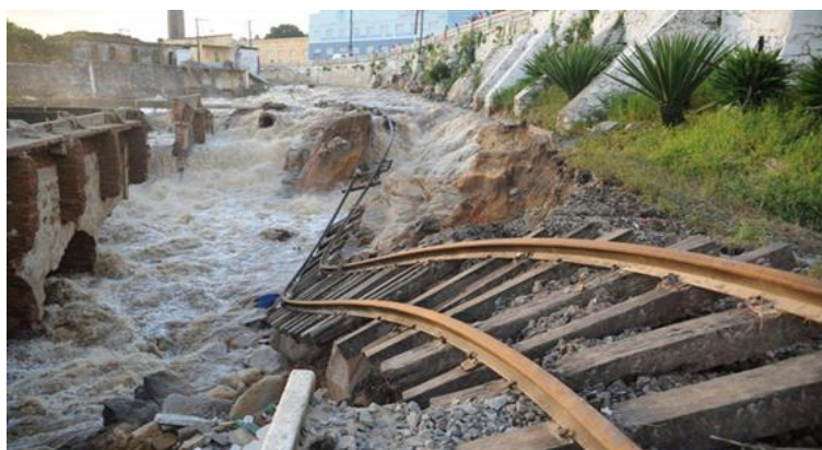
Figura 27: Destruição causada pela enchente de 2010 em Rio Largo/AL
