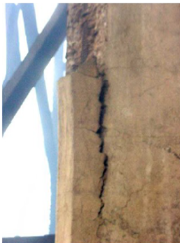
Figura 2.4 – Fenômeno "sloughing" em pilar
