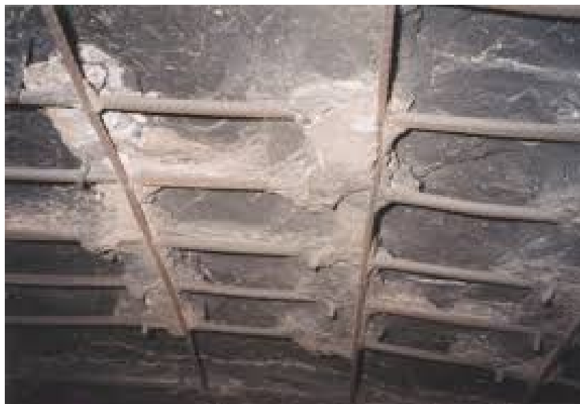
Figura 2.3 – Fenômeno "explosive spalling" em laje
