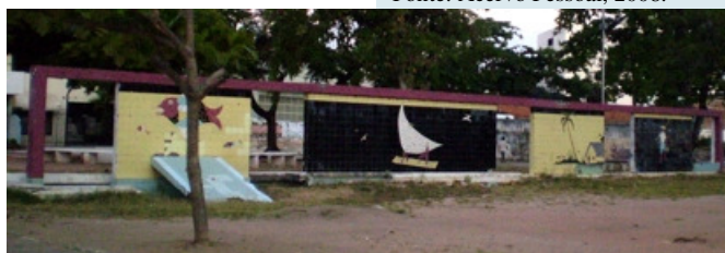
Figura 48 – Estado atual do painel azulejar da Praça Sinimbu.
