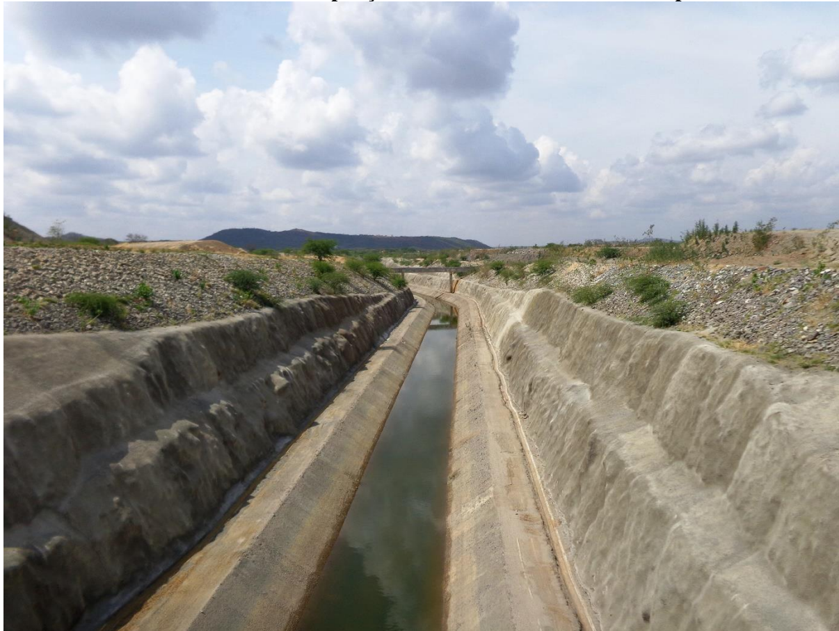
Foto 1 – Canal do Eixo-Leste da transposição do Rio São Francisco no município de Monteiro/PB
