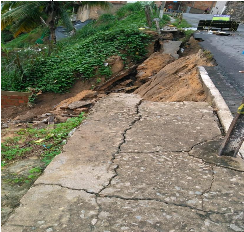
Figura 14: Deslizamento do acostamento da via
