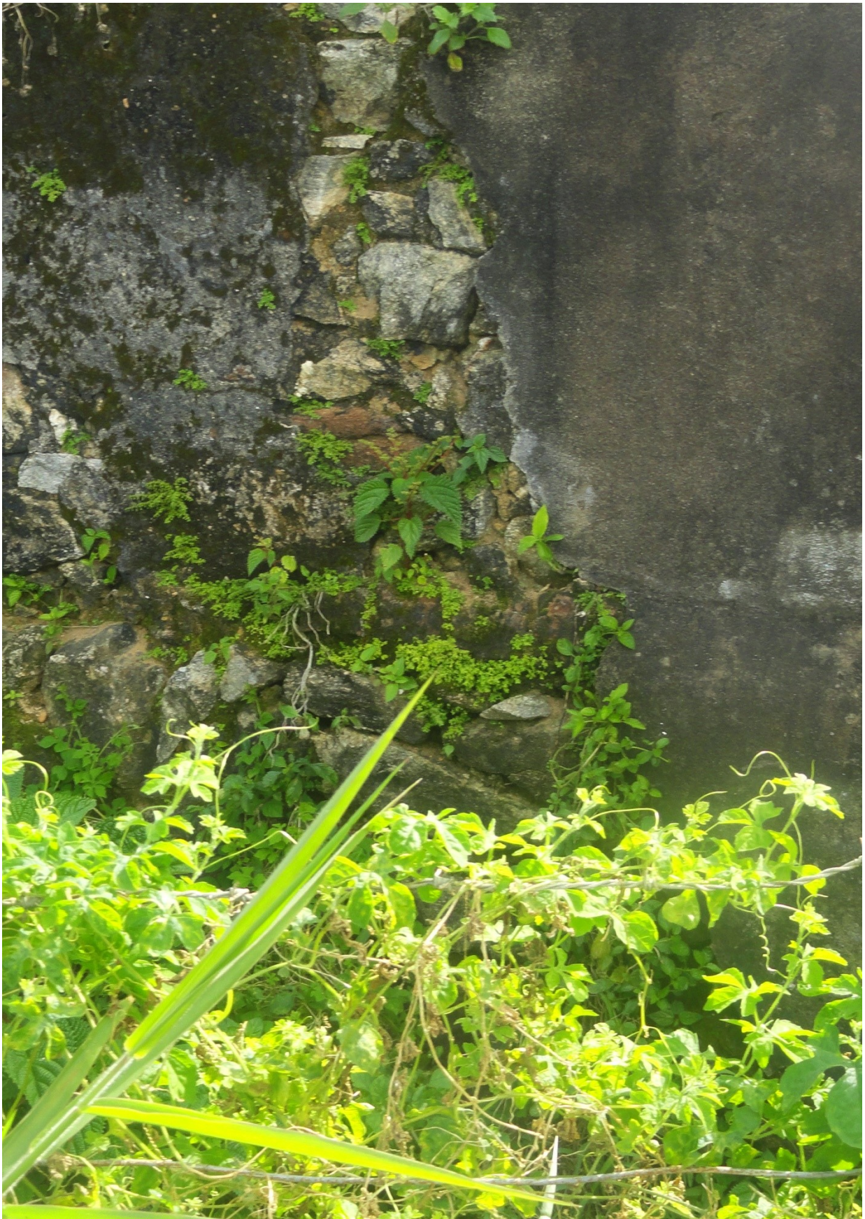
Figura 109 – Detalhe da união entre alvenarias (pedra e tijolo) de diferentes tempos, cemitério de Anadia-AL. Autor (2018)
