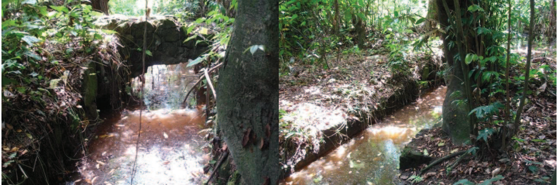
Figura 57: Vestígios construtivos de uma roda d'água no engenho Massangana, Cabo de Santo Agostinho - PE. Fonte: Grupo de Pesquisa Estudos da Paisagem, 2011.
