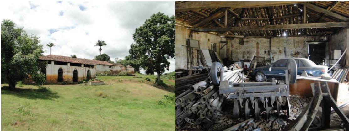
Figura 64: Engenho Uruaé, Goiana - PE. Antiga fábrica do engenho, com destaque para o mal estado de conservação.
