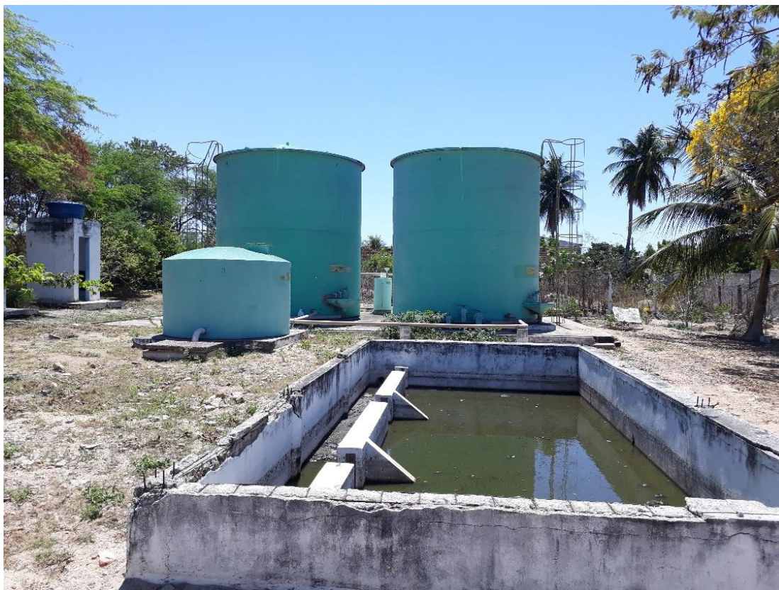
Estação de tratamento de esgoto do bairro Novo.
