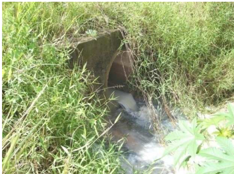
Figuras 25 – Tubulação de descarga na lagoa 3, com água proveniente da lagoa 2.
