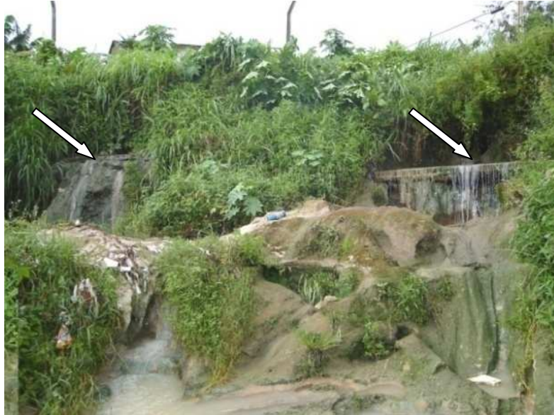
Figura 37 – Dois pontos de despejo de água na lagoa 3.
