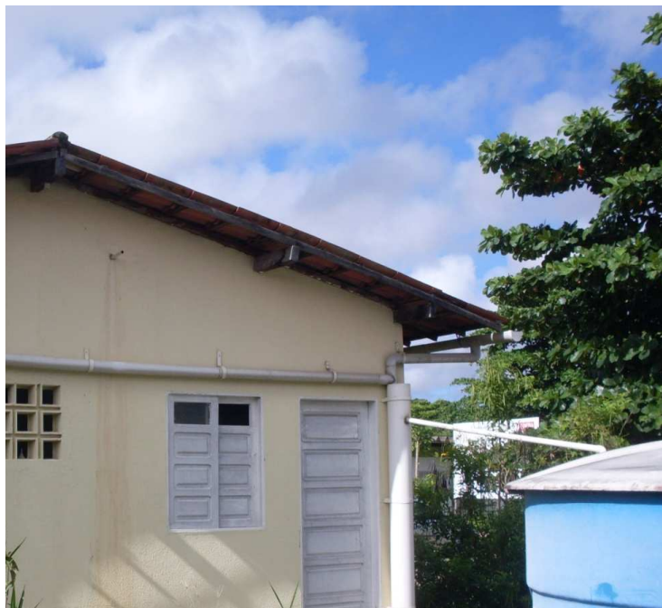
Figura 3. Estrutura de captação, transporte e armazenamento da água de chuva.
