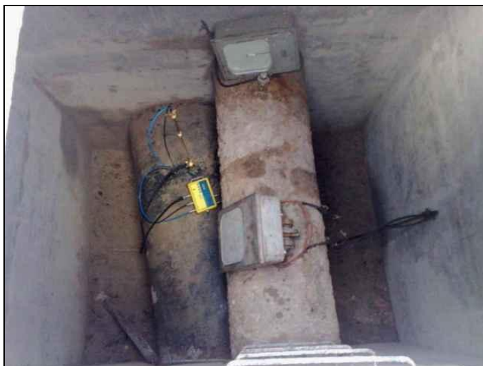
Figura 36 – Medição de vazão na adutora DN1000 com tubo pitot e de pressão com data logger diferencial. Fonte: CASAL (2010).
