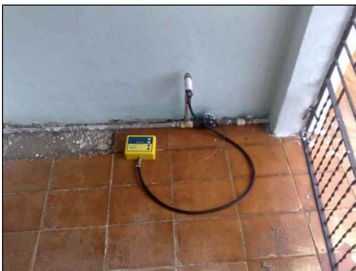
Figura 38 – Data Logger de pressão instalado na rua Salvador Calmon. Fonte: CASAL (2010).
