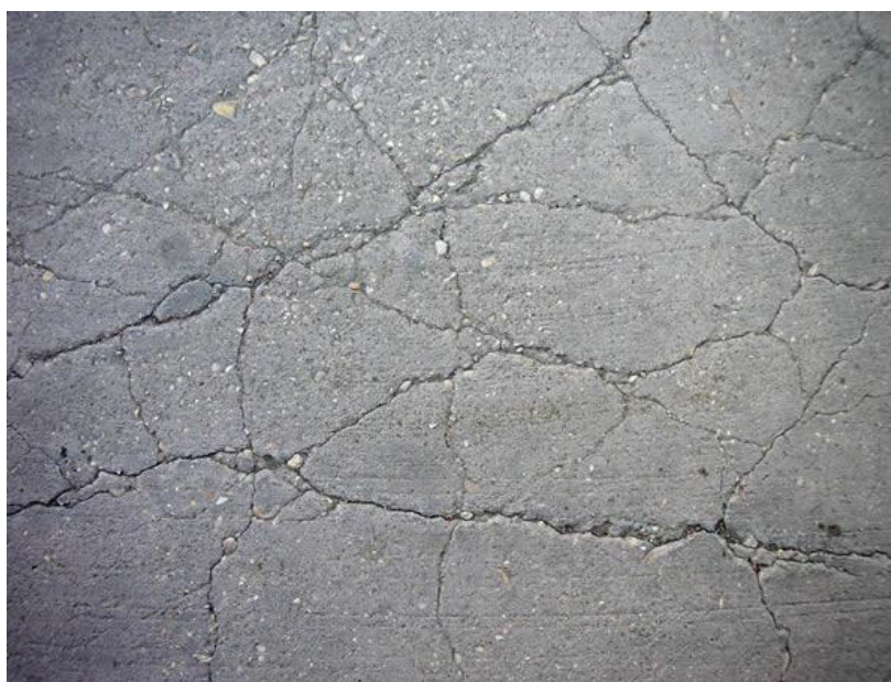
Figura 12: Fissuras no concreto provocadas por retração. Fonte: Schwartz (2009).
