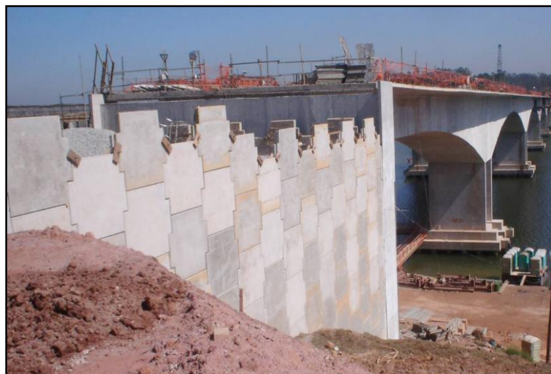
Figura 04: Obra de contenção utilizando a técnica Terra Armada, situada no Rodoanel Mário Covas - SP. Fonte: www.muroarmado.com.br
