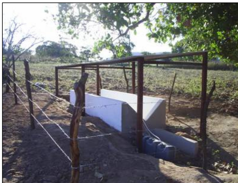
Figura 42. Fossa coletora de sedimentos
