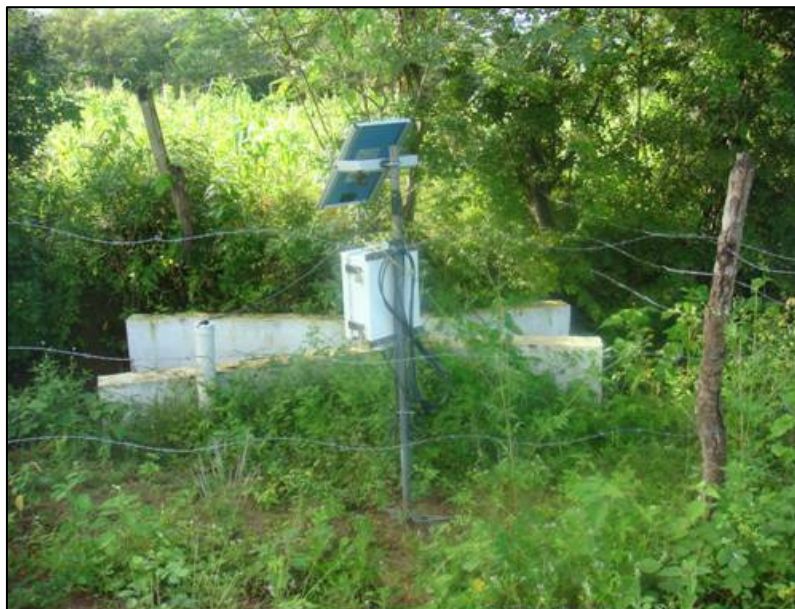
Figura 37. Calha Parshall da sub-bacia 02
