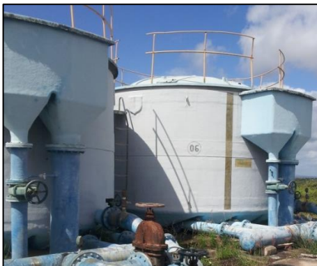
Figura 5 – Filtros situados na ETA de Delmiro Gouveia, AL.
