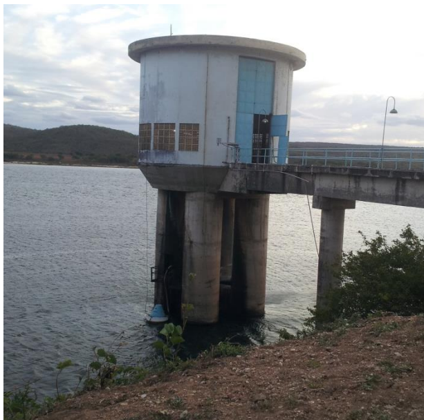
Figura 9 – Manancial captação e estação elevatória do Rio São Francisco em Pão de Açúcar – AL.
