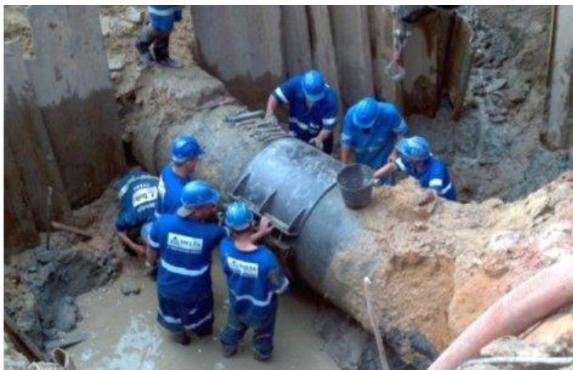
Figura 10 – Adutora da CESAN.
