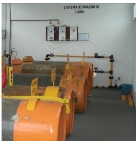
Figura 22 – Sistema de dosagem de cloro gasoso.
