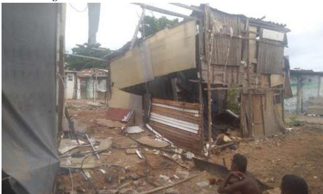
Imagem 41: Barraco com altíssimo risco de desmoronamento
