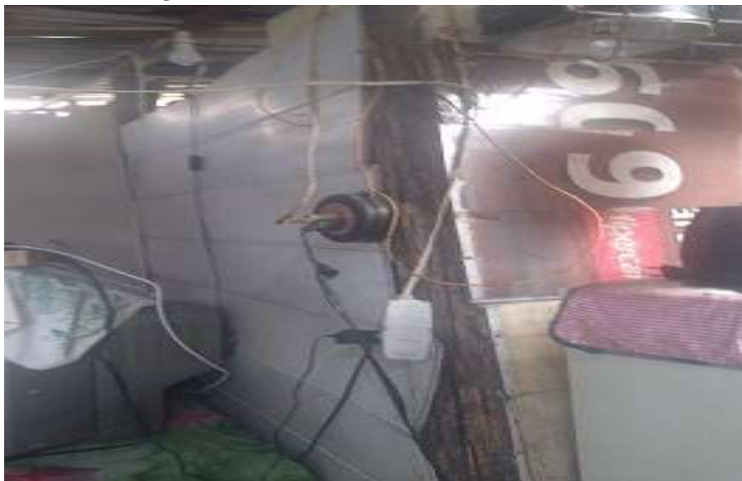
Imagem 30: Barraco com alto risco de curto-circuito
