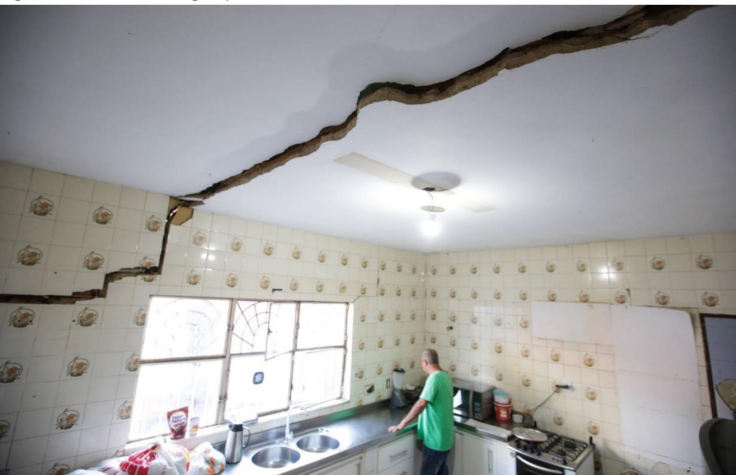
Figura 12: Residência atingida pela subsidência do solo no bairro do Pinheiro.
