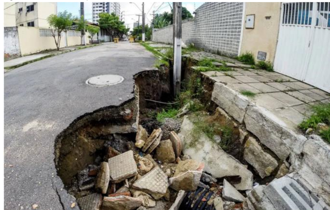
Figura 11: Cratera em via pública no bairro do Pinheiro.
