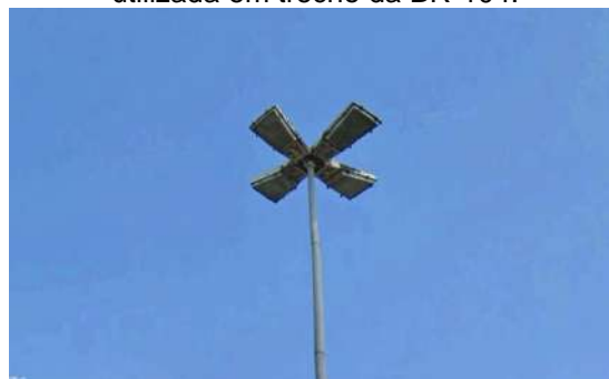
Figura 109 – Luminária modelo 4 pétalas utilizada em trecho da BR-104.
