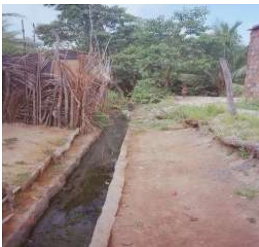
Figura 50 - Esgoto a céu aberto em várias ruas do povoado.
