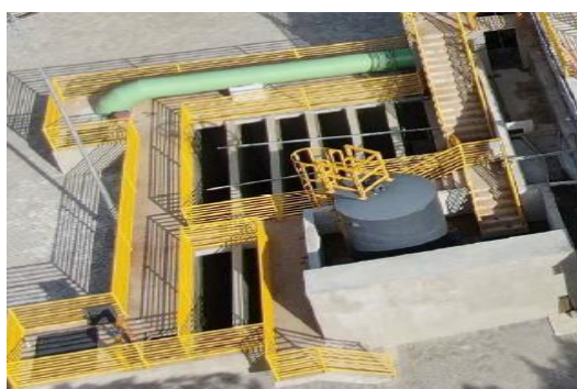
Figura 25 - Visão do tanque de contato
