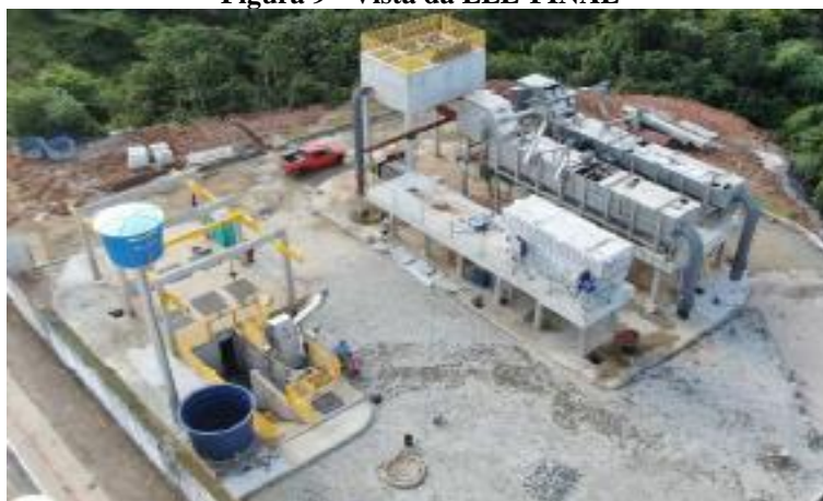
Figura 9 - Vista da EEE-FINAL
