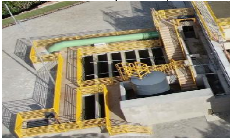
Figura 12 - Visão do tanque de desinfecção
