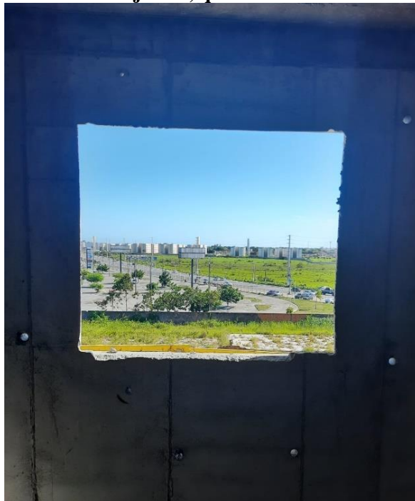
Figura 23 - Moldura inferior de janela, quebrada durante a atividade de desfôrma
