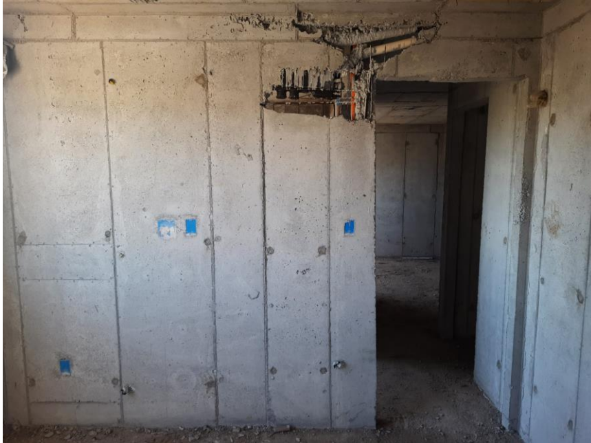
Figura 22 - Falha de concretagem observada durante inspeção após desfôrma
