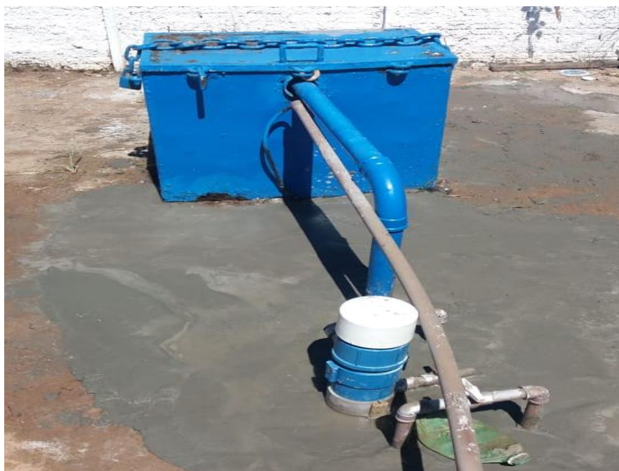
Figura 04 - Poço e clorador
