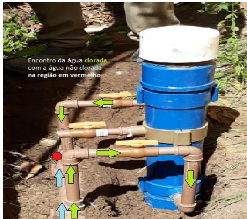
Figura 06 - Clorador com fluxo de água
