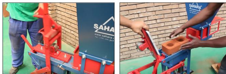
Figura 10: Fabricação de tijolos de solo e cimento: (a) solo e cimento sendo prensados; (b) tijolo prensado.
