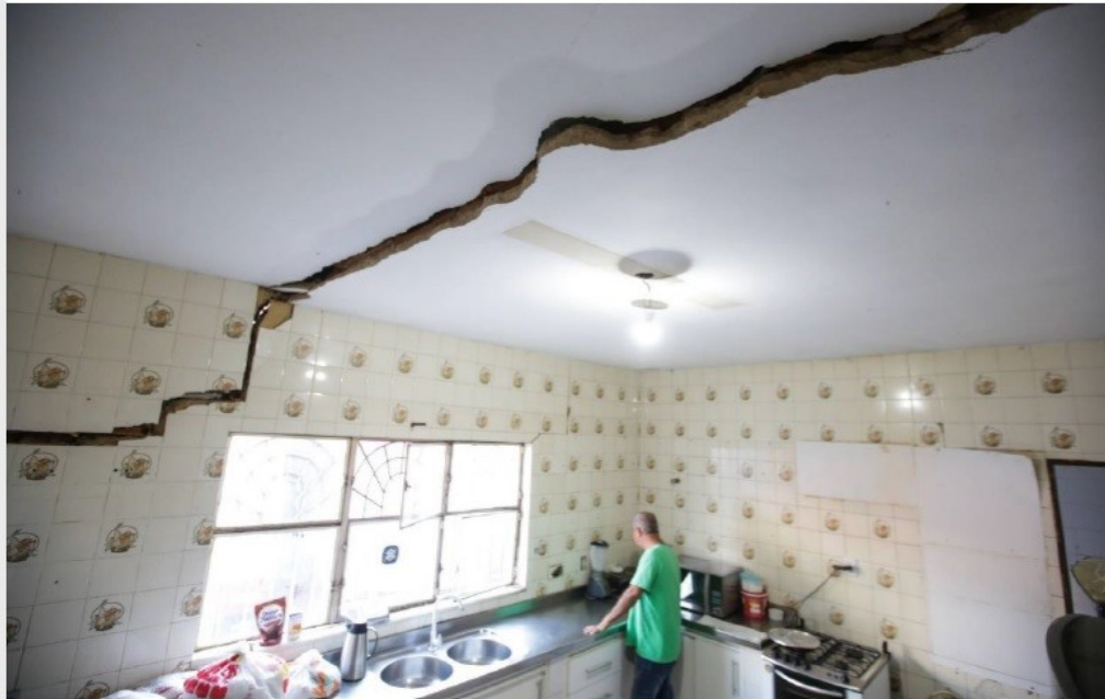
Figura 01 – Residência atingida pela subsistência no bairro do Pinheiro
