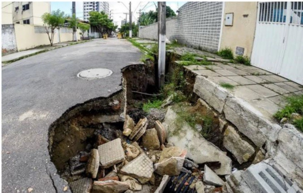
Figura 02 – Afundamento de parte da rua no bairro do Pinheiro
