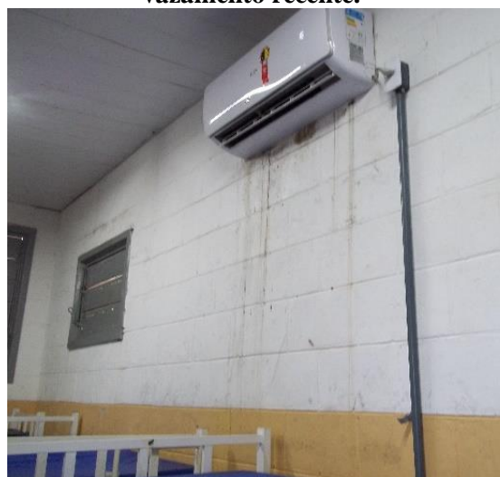
Figura 25- Ar condicionado aparentando vazamento recente.
