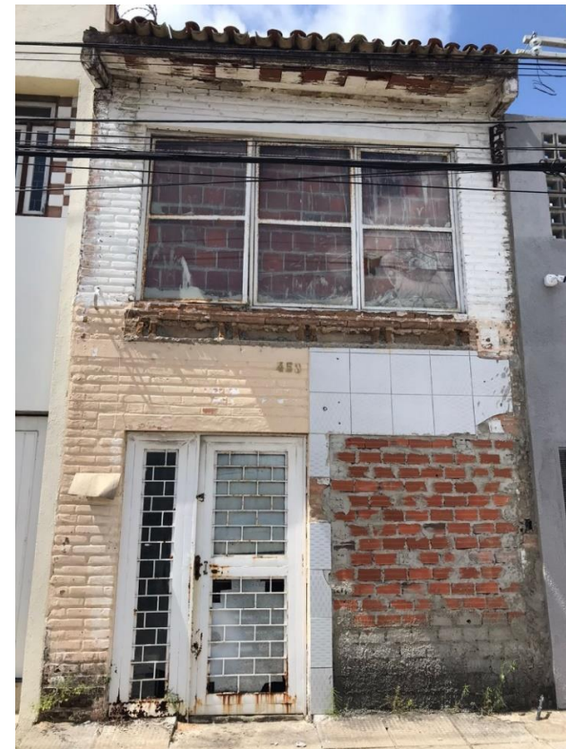
Figura 32. imóvel abandonado em mau estado de conservação.
