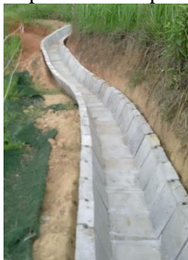
Figura 17 - Drenagem superficial do tipo canaletas pré-moldadas
