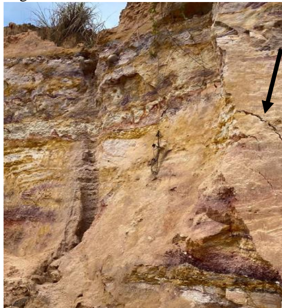
Figura 47 - Evidência de trincas no terreno
