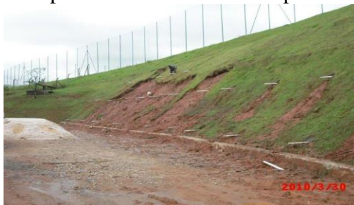
Figura 21 - Exemplo de drenos horizontais profundos instalados
