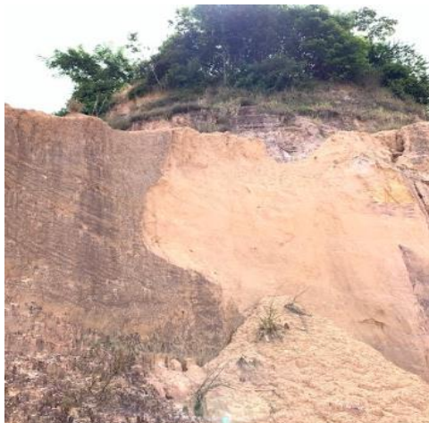
Figura 51 - Evidência de movimento translacional
