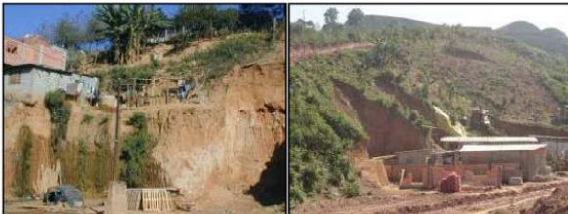
Figura 13- Cortes com declividade excessiva e altura expressiva
