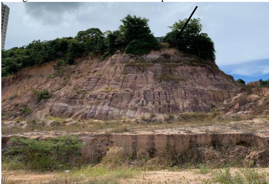
Figura 57 - Evidência de moradores perto do limite do talude
