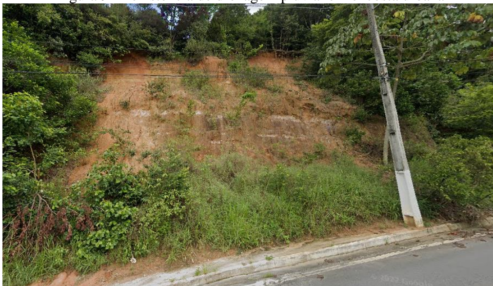
Figura 9- Inexistência de drenagem pluvial em encosta urbana
