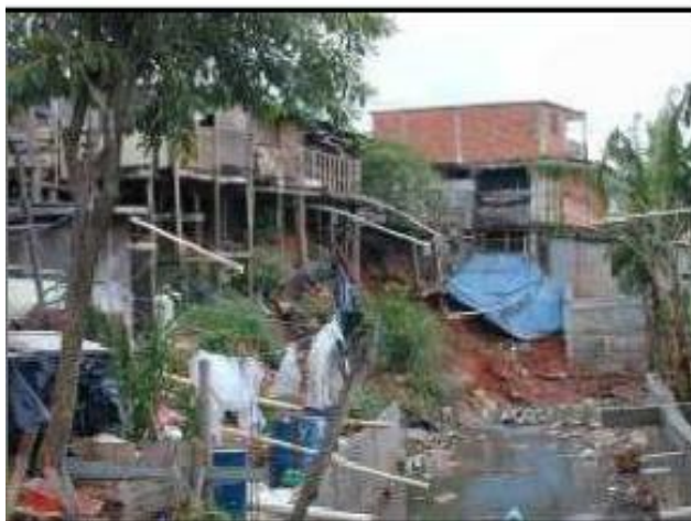
Figura 11- Vazamento da rede de distribuição de água
