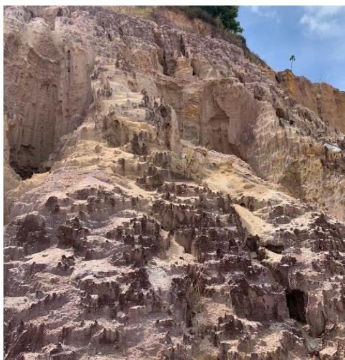
Figura 45 – Feições erosivas que favorecem a infiltração de água
