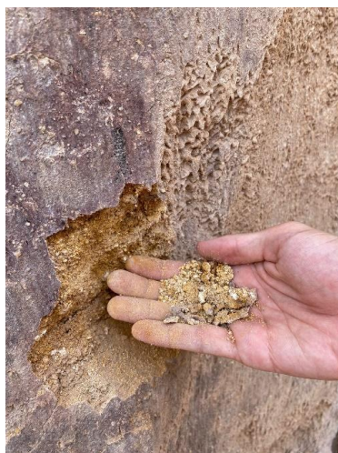
Figura 44- Evidência da baixa resistência mecânica.
