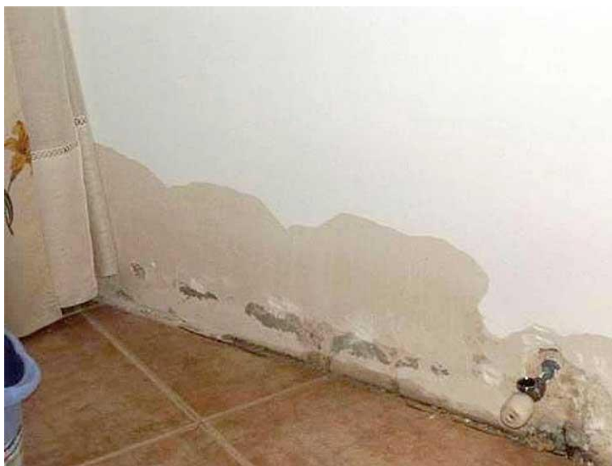
Figura 16 - Umidade ascendente por capilaridade
