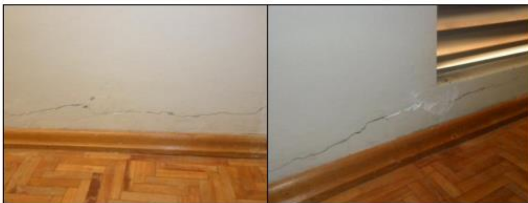
Figura 24 - Fissura horizontal em alvenaria
