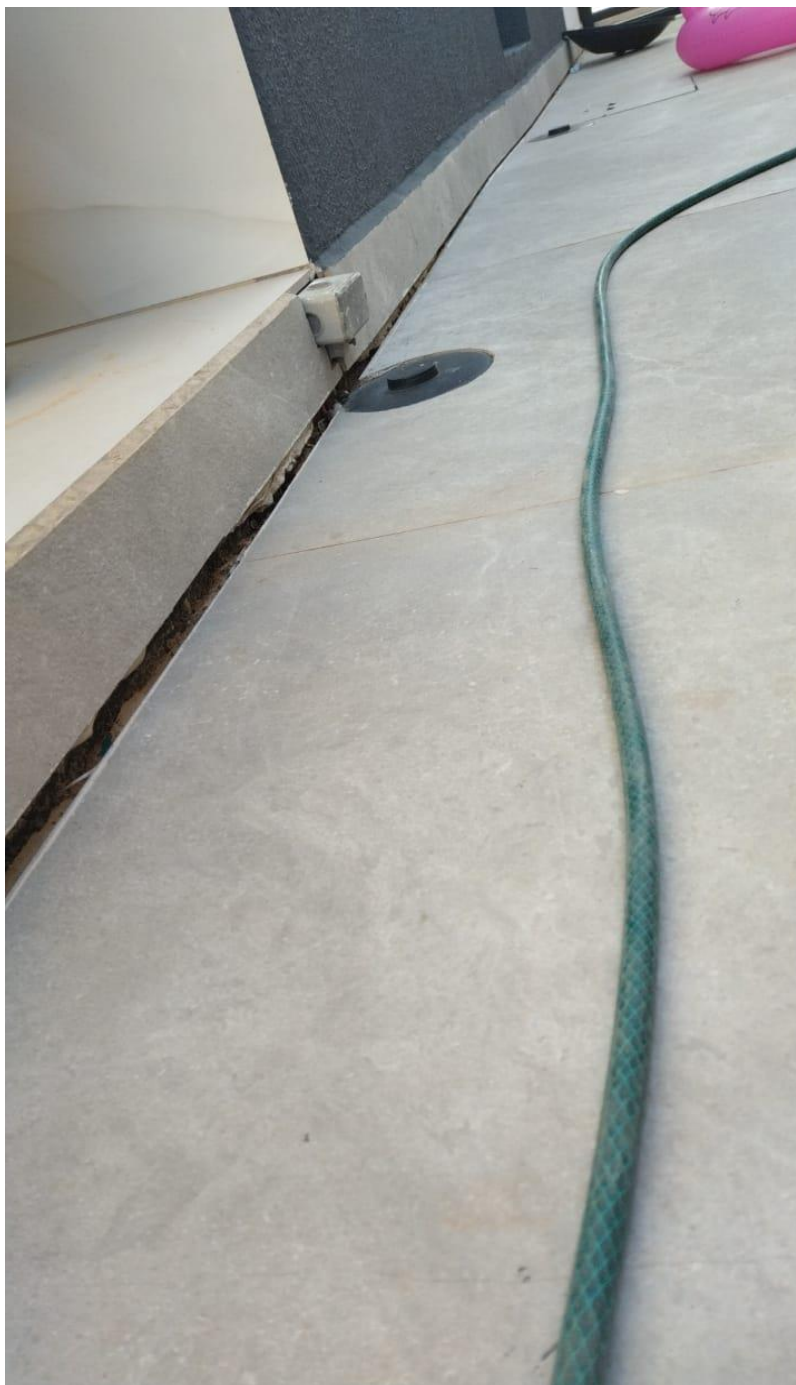
Figura 33 - Recalque de piso corredor - Edificação 1
