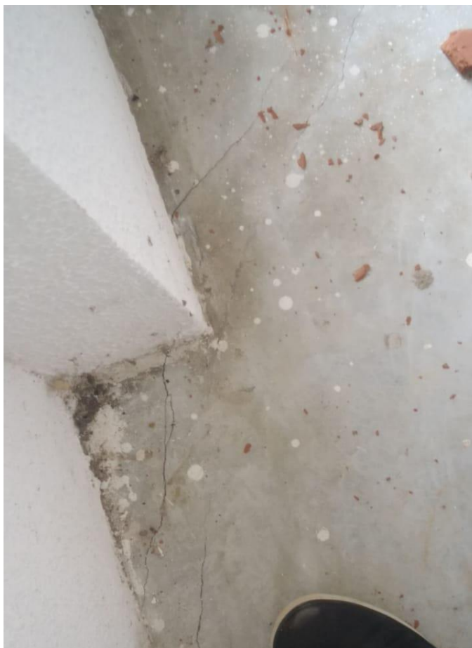
Figura 39 - Trincas em todo o perímetro do piso - Edificação 3
