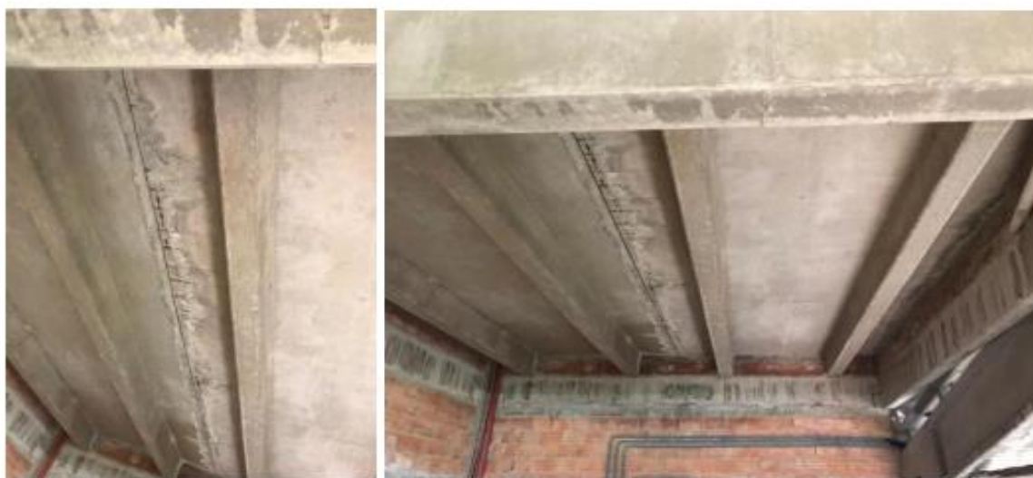
Figura 22 - Corrosão da armadura laje
