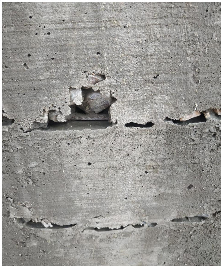
Figura 42 - Falha no adensamento do concreto - Edificação 3
