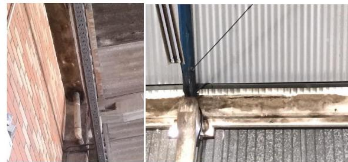
Figura 21 - Manchas por infiltração
