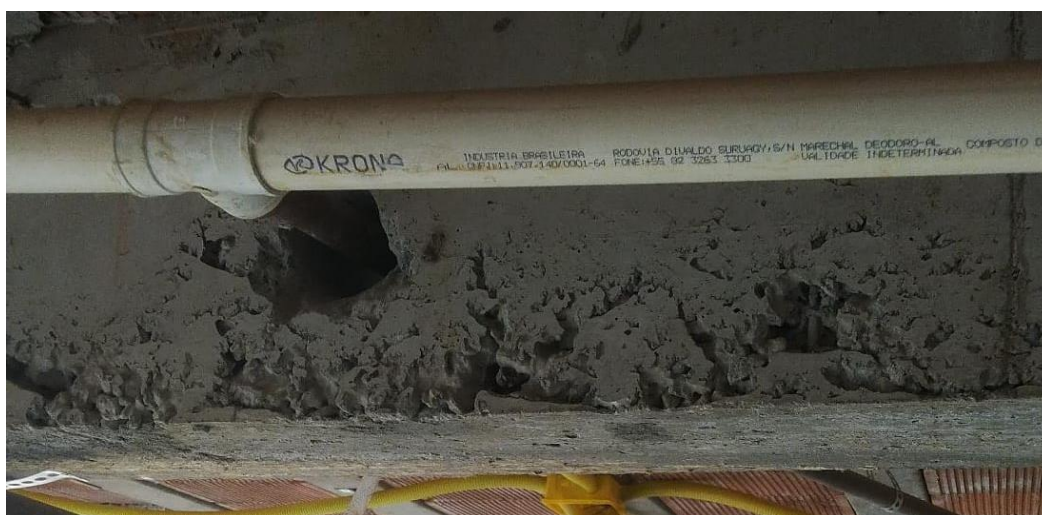
Figura 41 - Viga com falha no adensamento e armadura exposta edificação 3
