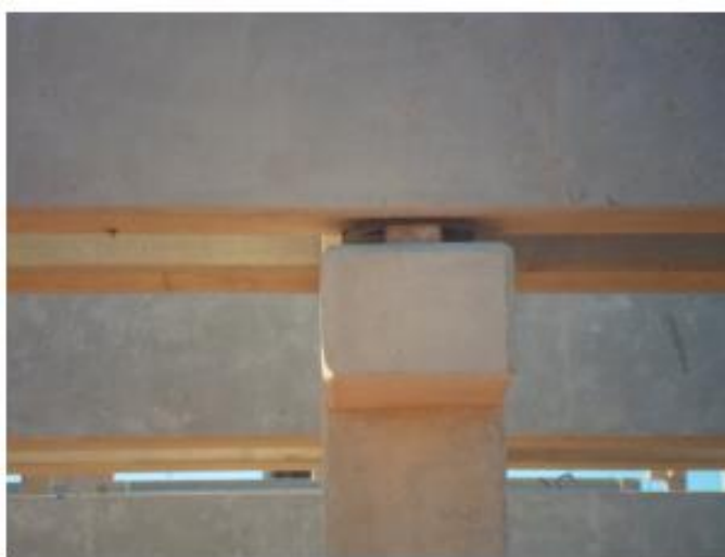
Figura 20 - Calço em consolo de concreto
