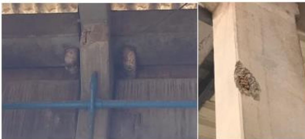
Figura 25 - Desplacamento do concreto
