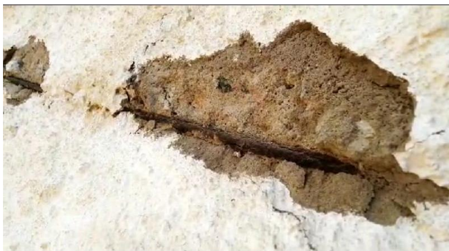
Figura 43 - Corrosão da armadura - edificação 3
