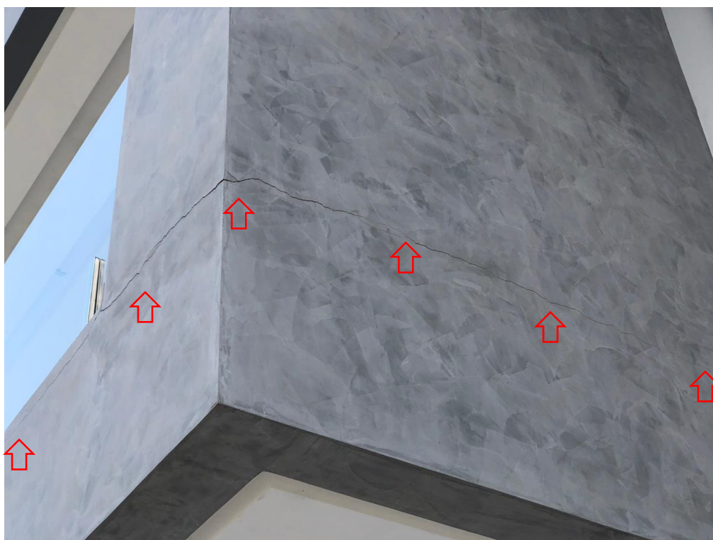
Figura 29 - Fissura horizontal - Edificação 1
