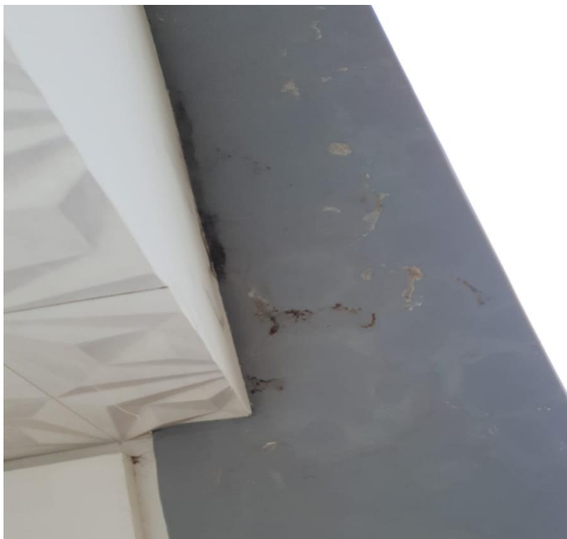
Figura 34 - Manchas por umidade em parte interna de laje de cobertura - Edificação 2
