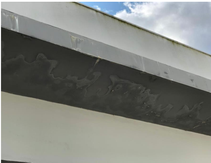
Figura 32 - Manchas em marquise - Edificação 1
