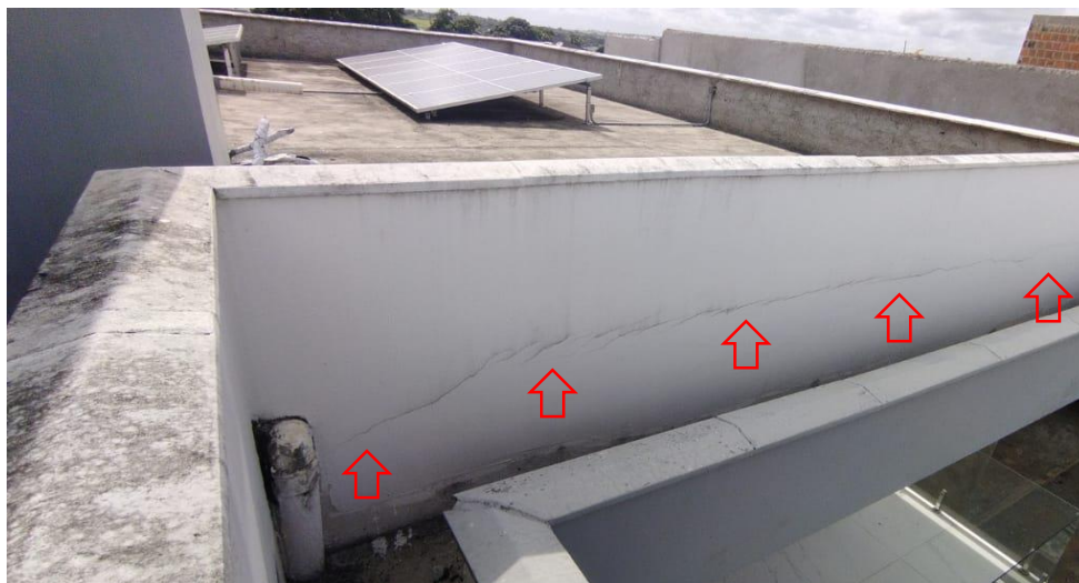
Figura 30 - Fissura horizontal no nível da laje de cobertura - Edificação 1
