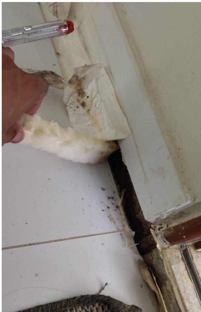
Figura 36 - Recalque no piso interno da residência - Edificação 2
