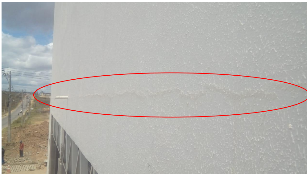
Figura 37 - Fissura horizontal - Edificação 3
