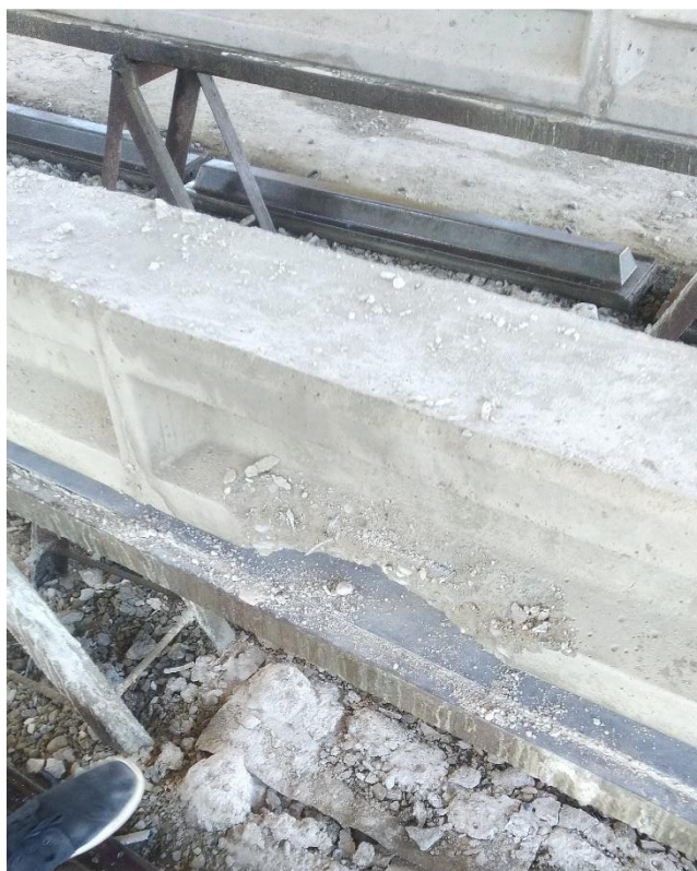
Figura 19 - Pilar Danificado na produção e armadura exposta
