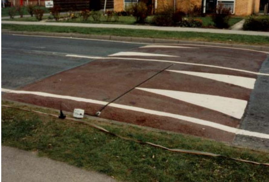
Figura 39 - Ondulação construída em material asfáltico
