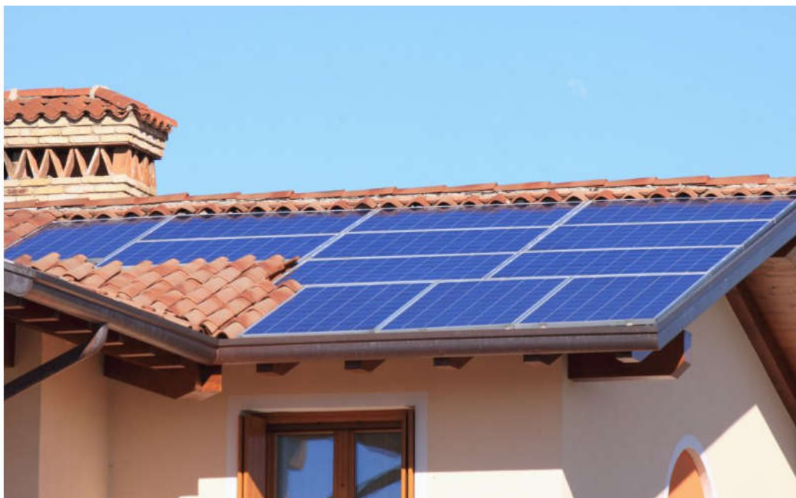
Figura 3 - Painel Solar sobre telhado residencial
