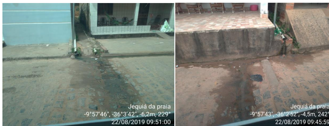
Figura 83– Esgoto doméstico a céu aberto
