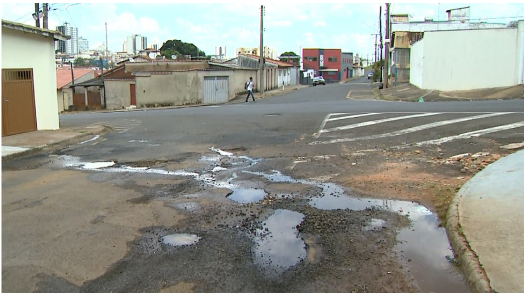
Figura 1: Rua esburacada na cidade de Franca, SP. Fonte: [G1 2019]
