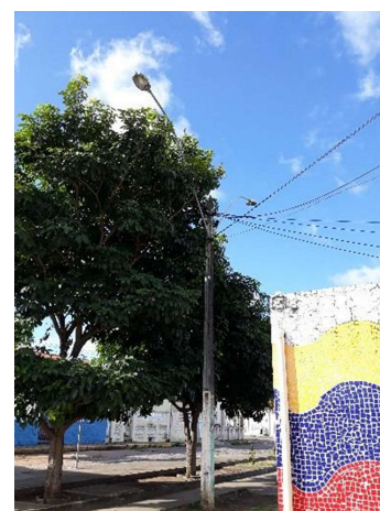
Figura 27 - Poste de 2 pétalas na Praça Humberto Mendes
