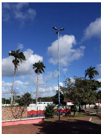
Figura 26 - Poste de 3 pétalas na Praça Humberto Mendes (LED)
