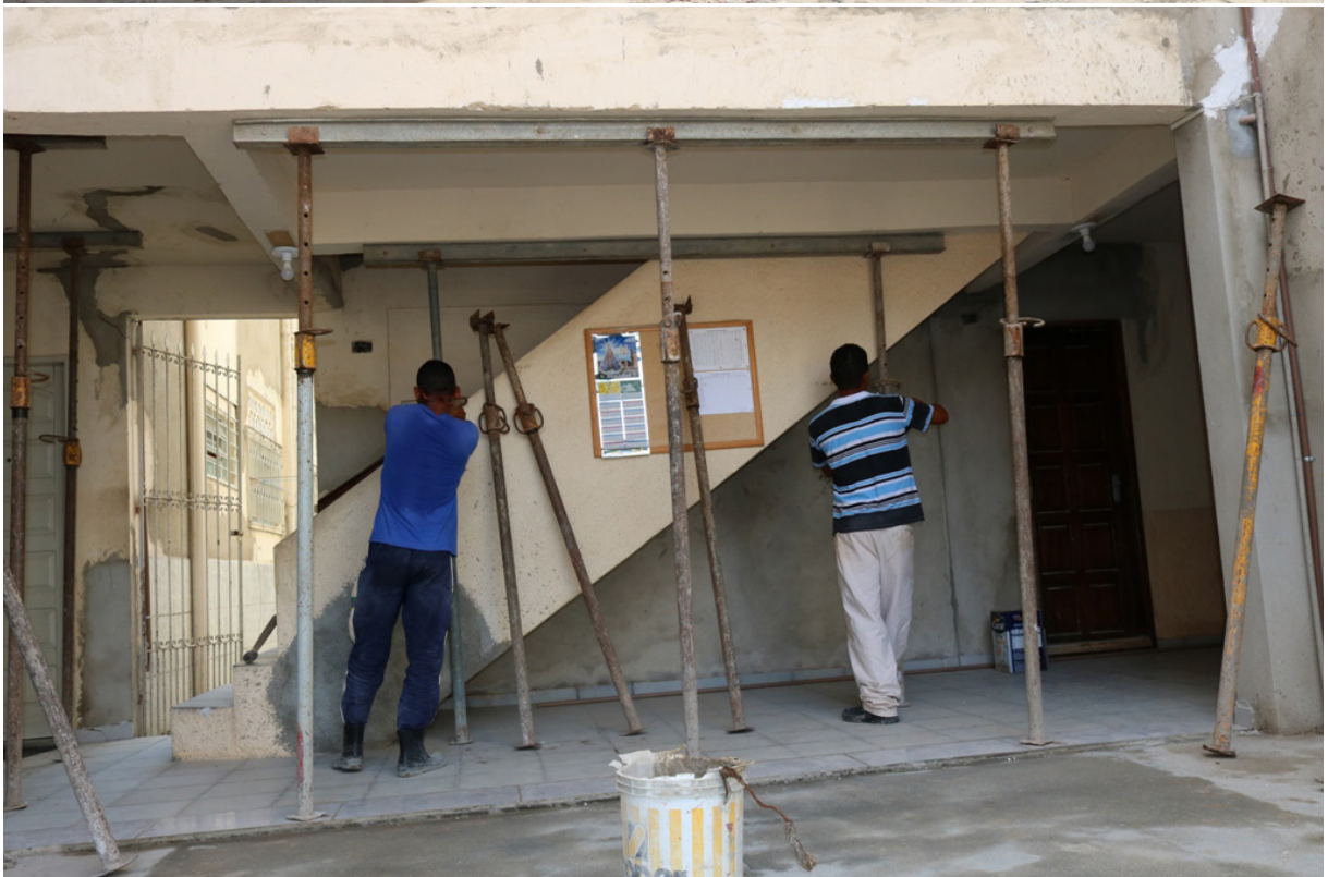
De cima para baixo: Figura 17 - Danos estruturais na fachada do Conjunto Divaldo Suruagy; Figura 18 - Vigas de apoio estrutural espalhadas no hall do Conjunto Divaldo Suruagy Fonte: [17]Cau Rodrigues (2018); [18] Acervo online do jornal Todo Segundo (2018)
