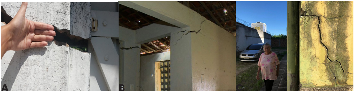
Figura 20 [a/b/c] - Danos estruturais nas residências do bairro do Pinheiro - Maceió (AL)
