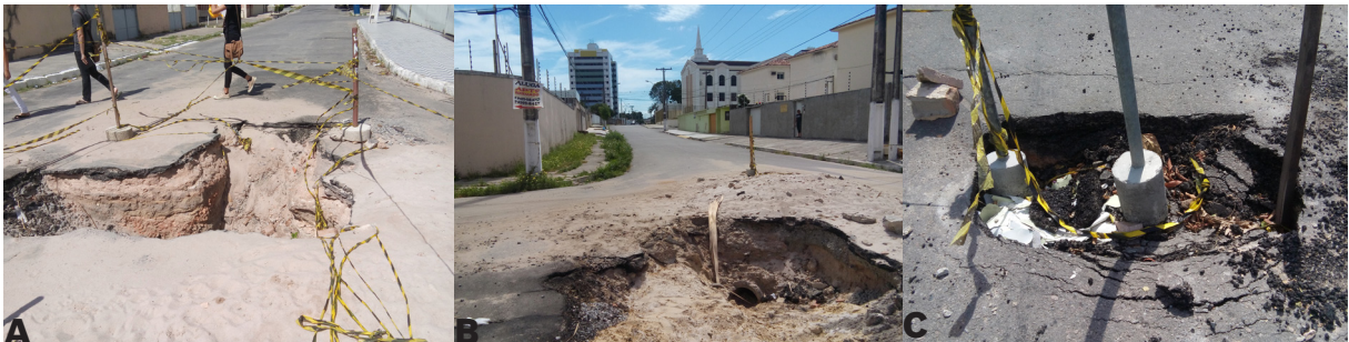
Figura 19 [a/b/c] - Rachaduras nas vias do bairro Pinheiro - Maceió (AL)
