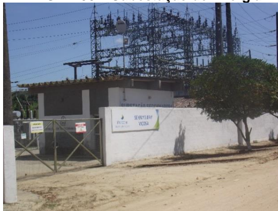
IMAGEM 38 – Subestação de Energia.
