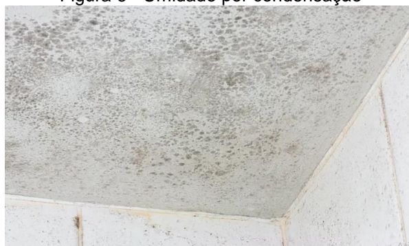
Figura 6 - Umidade por condensação
