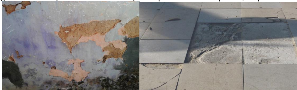
Figura 12 - Exemplo de descolamento por empolamento e em placas, respectivamente.
