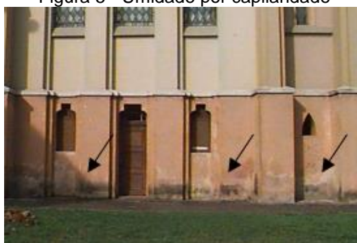
Figura 5 - Umidade por capilaridade
