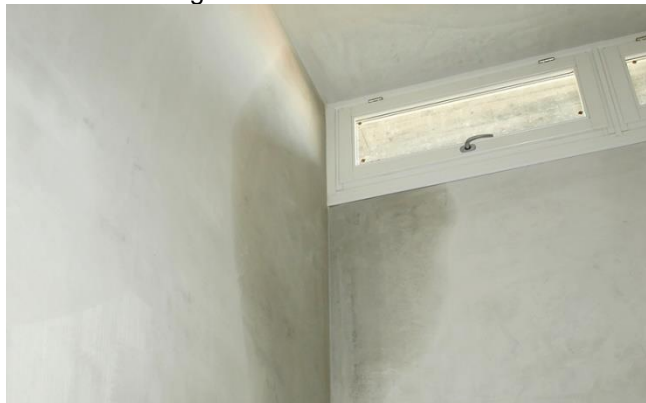
Figura 7 - Umidade de obra
