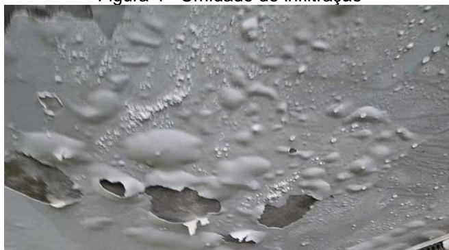
Figura 4 - Umidade de infiltração
