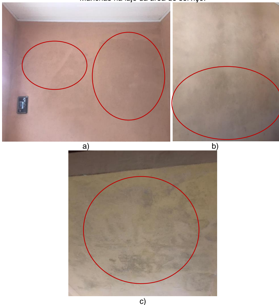
Figura 19 - Manchas de umidade na edificação: a) Manchas na área; b) Manchas no quarto 1; c) Manchas na laje da área de serviço.
