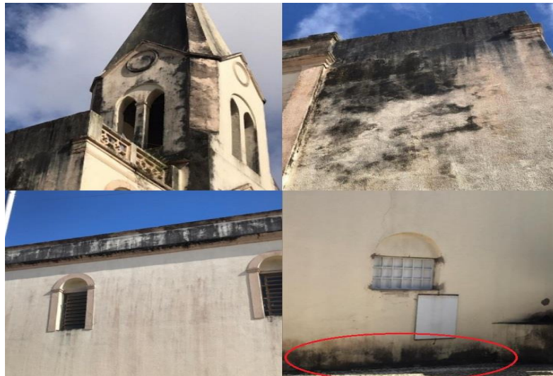
Figura 15: Manchas de umidade.
