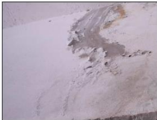
Figura 8: Descascamento de pintura.
