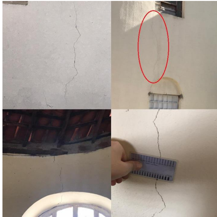
Figura 18: Fissuras e trincas.
