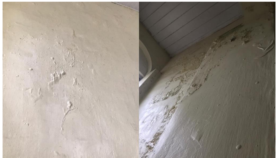
Figura 16: Empolamento da pintura.
