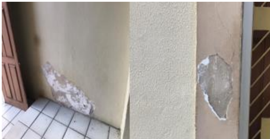
Figura 17: Eflorescência e descascamento da pintura.
