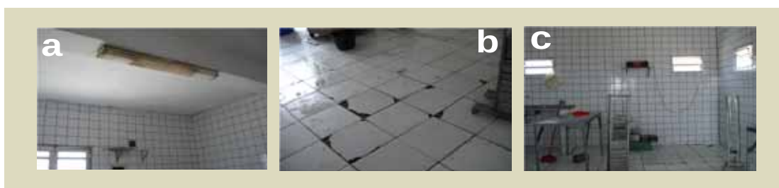
Figura 4.23 – Vista interna da Fabriqueta 4.
