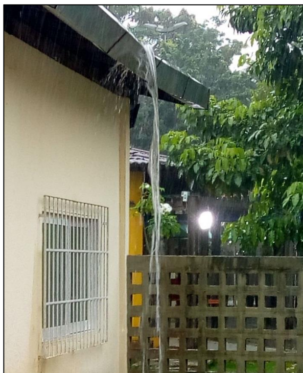
Figura 14 – Extravasamento de água em uma das calhas do telhado
