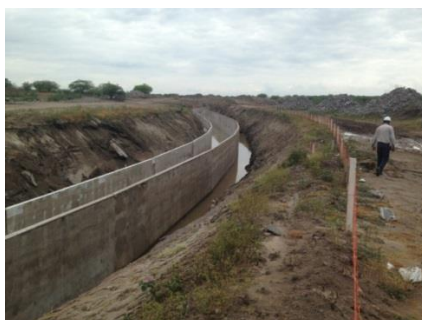
Figura 20 – Foto mostrando um trecho de canal retangular afetado pela chuva de dezembro de 2013
