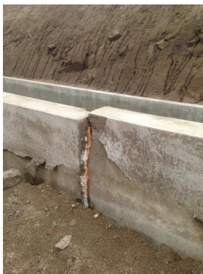
Figura 21 – Foto mostrando os efeitos do esforço de subpressão devido a ocorrência de chuva intensa na região
