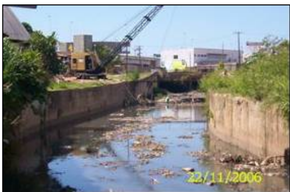
Figura 26 – Acúmulo de sedimento no sistema de drenagem
