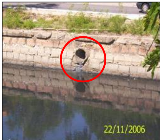
Figura 5 – Presença de esgoto na galeria de água pluvial
