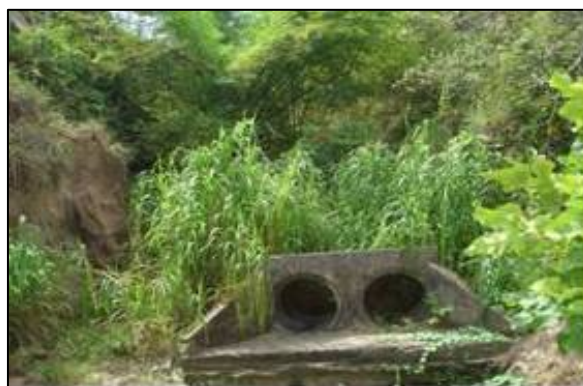
Figura 27 – Deterioração do sistema de drenagem
