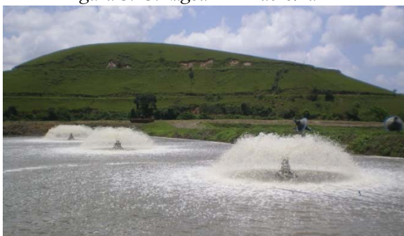
Figura 5.15: Lagoa 3 - 3 aeradores de superfície
