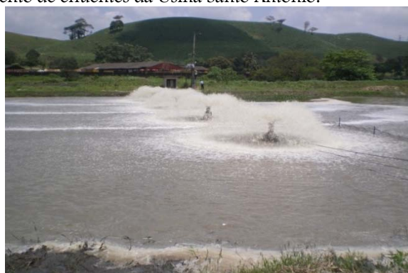
Figura 5.14: Lagoa 2 - 4 aeradores de superfície
