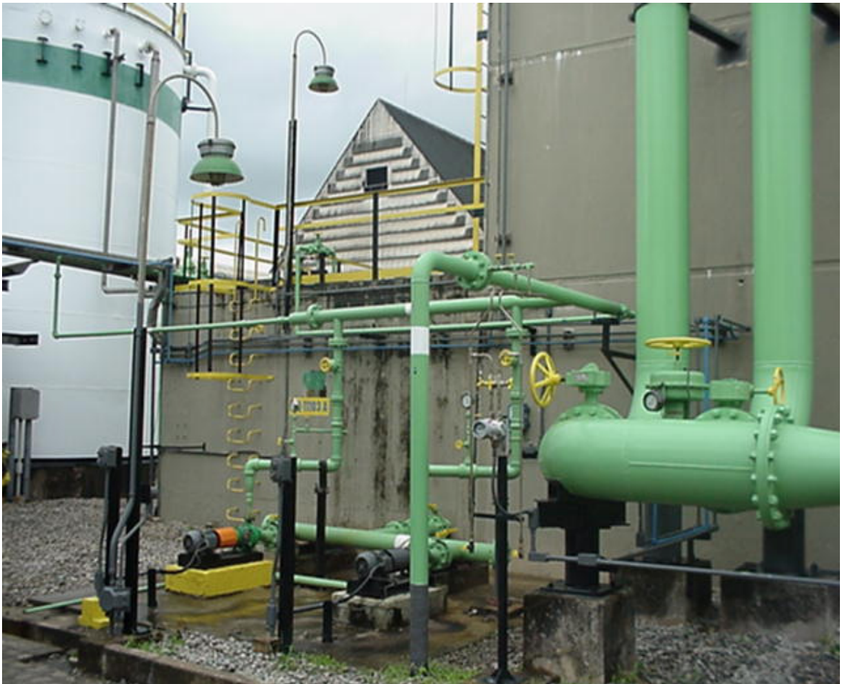
Figura 28- Vista do sistema de água potável (tanque e bombas).
