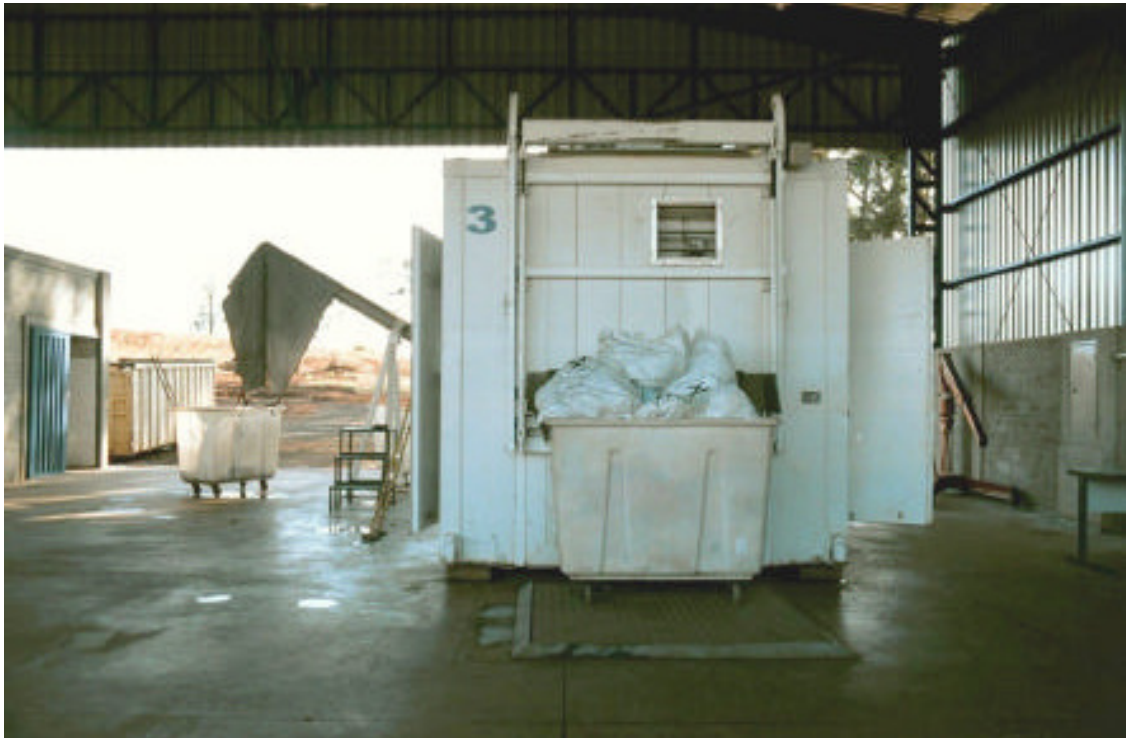
Figura13- Forno de microondas instalado no aterro sanitário de Ribeirão Preto.
