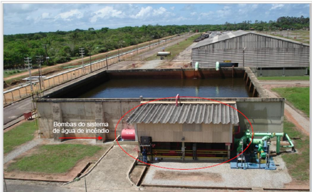
Figura 26- Vista do tanque de água bruta.
