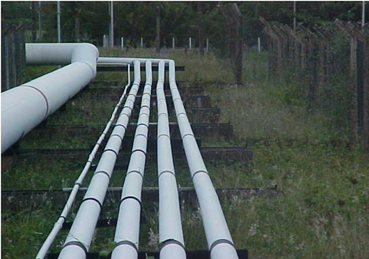
Figura 31- Vista das tubulações instaladas na tubovia.
