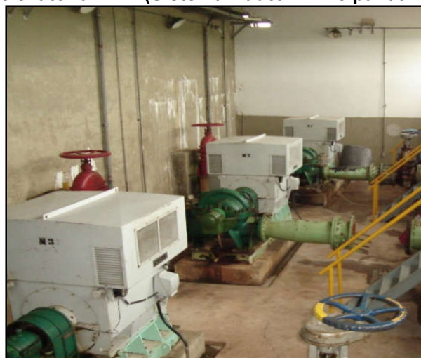
Figura3.4– Estação elevatória EE-1 (Sistema Adutor Principal da Bacia Leiteira)
