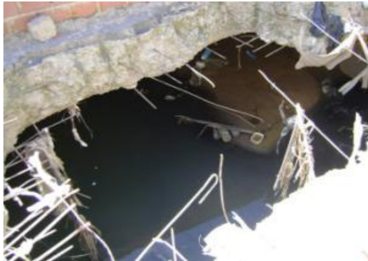
Figura 5.5. Abertura encontrada no conduito 020 revelando acúmulo de sedimentos
